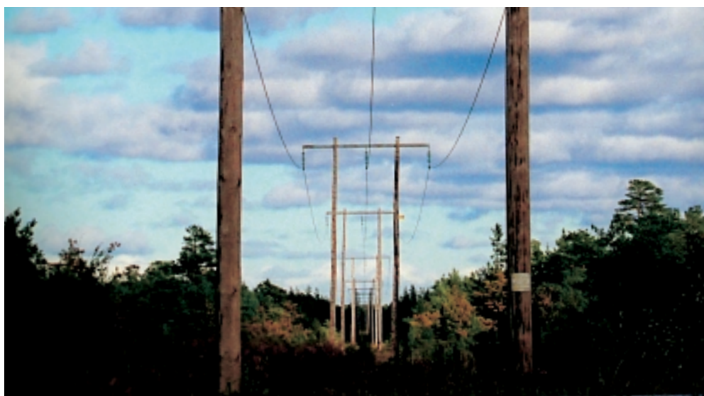
Kraftledning (70 kV), Gotland, Sverige.
