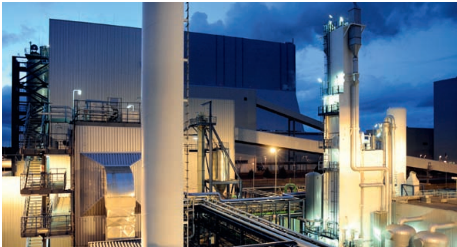
Kraftanläggningen i Schwarze Pumpe, Tyskland
