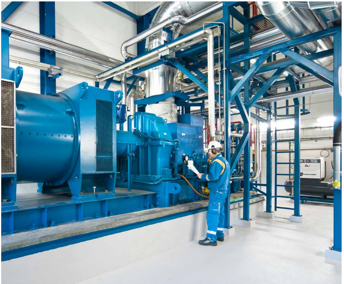
Vattenfalls fokus på hälsa och säkerhet har lett till att den olycksrelaterade frånvaronivån (LTIF) har sjunkit från 2,0 under 2016 till 1,5 under 2017.
